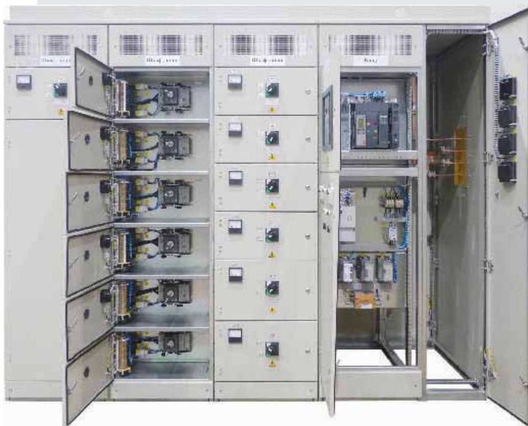
Комплектная трансформаторная подстанция (фрагмент щита РУНН)
